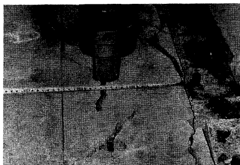
写真-7 ひび割れ幅の確認
