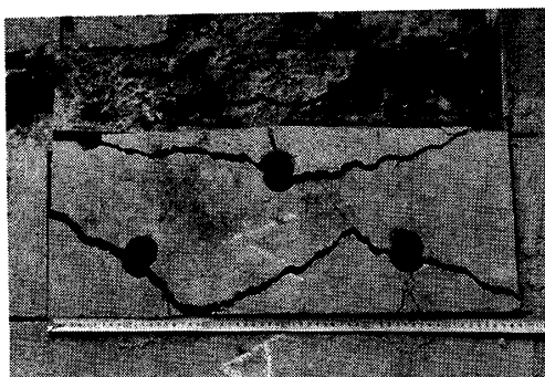
写真-10 破碎状況
