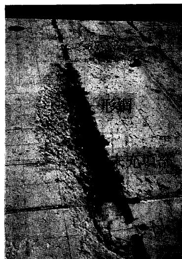
写真-1 未充填部発生の状況
