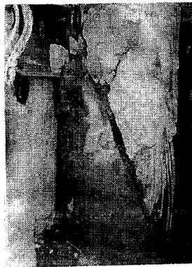
写真-1 地震による杭のせん断破壊例
