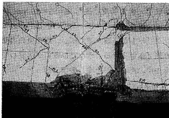
写真-2 中央部最終破壊状況 (No. 4)
