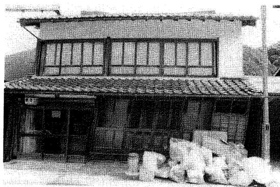
写真3-4-1 日野町黒坂地区の住宅と被害
