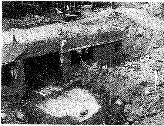
写真1 花蓮県光復郷大興村で発生した土石流によって埋没した白雲山荘の発掘状況
