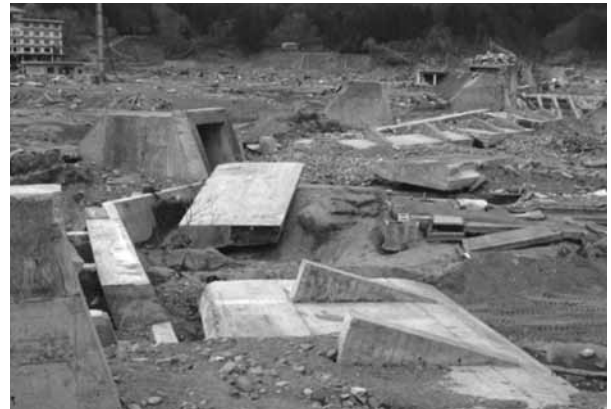
写真3 岩手県宮古市田老地区の10mの防潮堤の倒壊の様子
