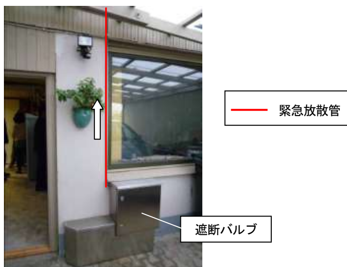
図3. 3. 3. 5 緊急放散装置
