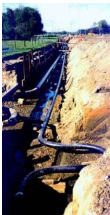
図3. 3. 2. 2 Air Liquide 社の水素パイプライン埋設配管
