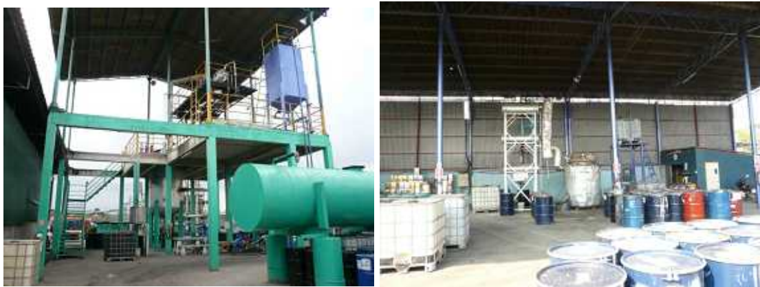
図 3.20 廃溶剤の再生工場の例
