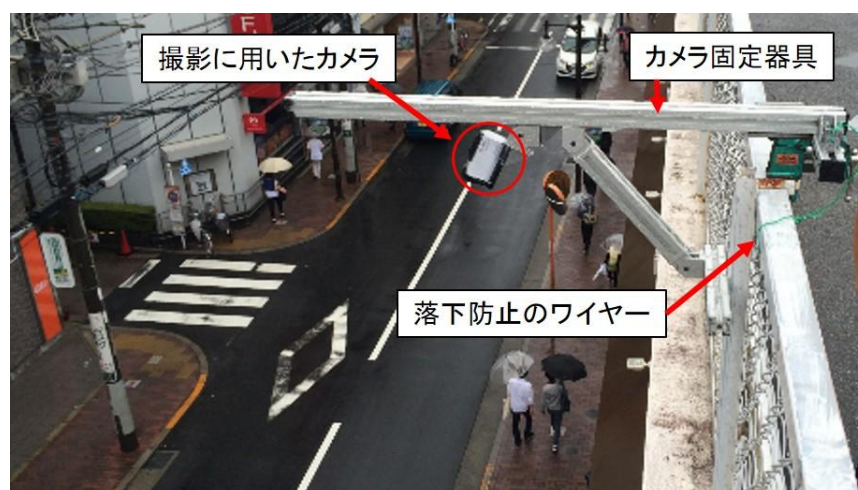
図 4.3.4-2 設置したカメラの様子
