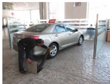
(e) 排ガス吸収設備
