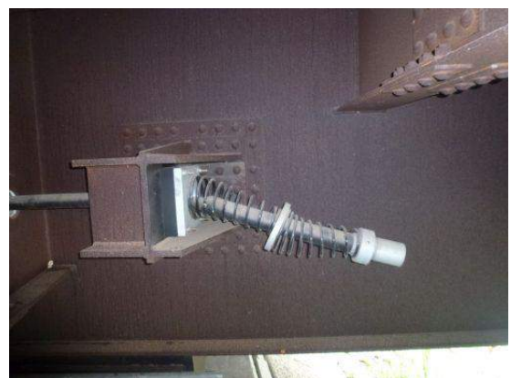
(b) 落橋防止ケーブルの塑性変形
