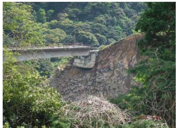
写真-1 柱状節理の発達した立野溶岩の崩落で阿蘇長陽大橋の橋台が下方へ移動
