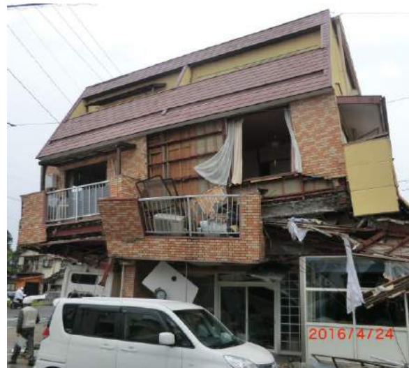
写真-5 倒壊した鉄骨造 4 階建ての店舗兼住宅。溶接部の破断により 2 階部分が層崩壊している。
