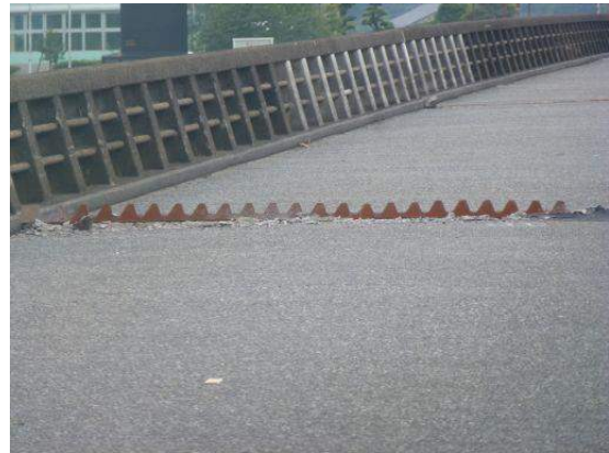
(b) 伸縮装置の損傷
