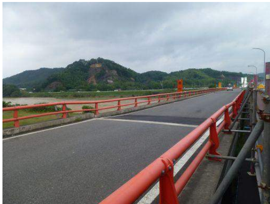
写真-5 乙女橋の被災状況
