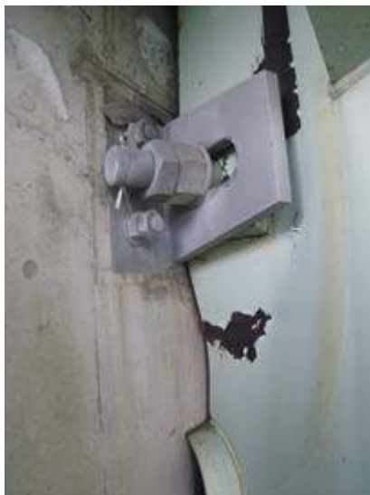
(c) 桁橋と橋台パラペット部の衝突
