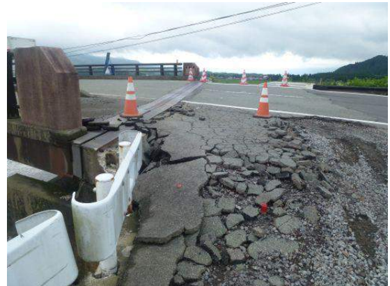
(a) 左岸側橋台の損傷
