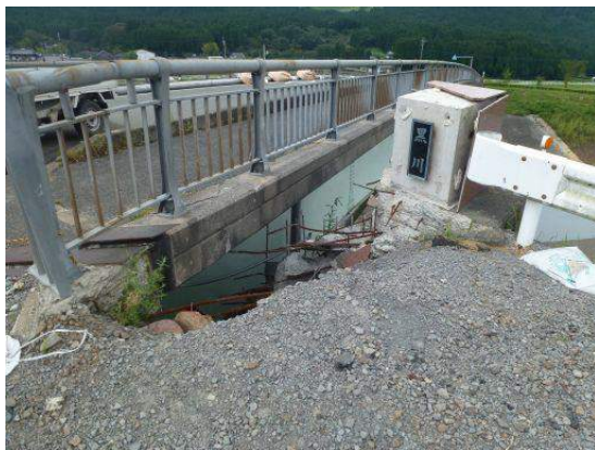
(b) 左岸側橋台の損傷
