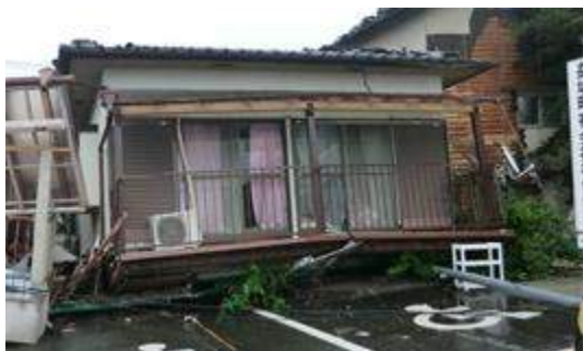
写真-2 1981年以前に建てられた木造住宅。1階部分が層崩壊している。
