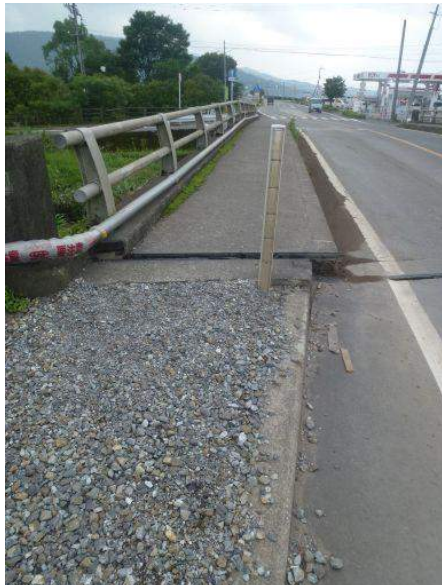
写真-2 畑中橋の被災状況
