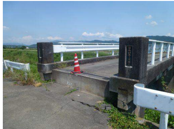
写真-3 第二宮園橋の被災状況
