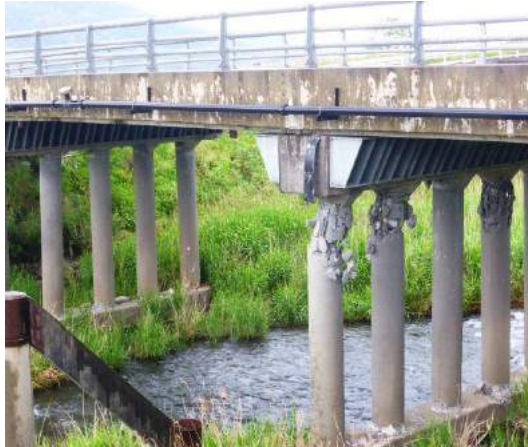
写真-1 第一畑中橋の被災状況
