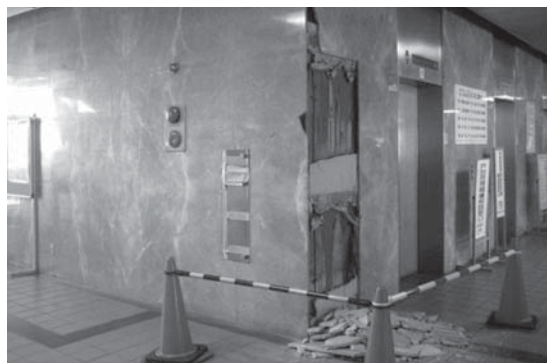
被害を受けた仙台合同庁舎
