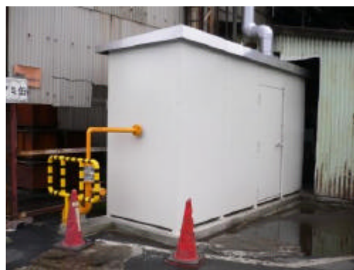
ガス減圧装置
