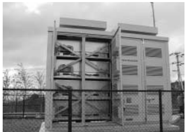
NAS電池。秒単位で出力変動する風力発電所の出力を安定させる。島内の電力の周波数が安定する効果がすでに現れている
