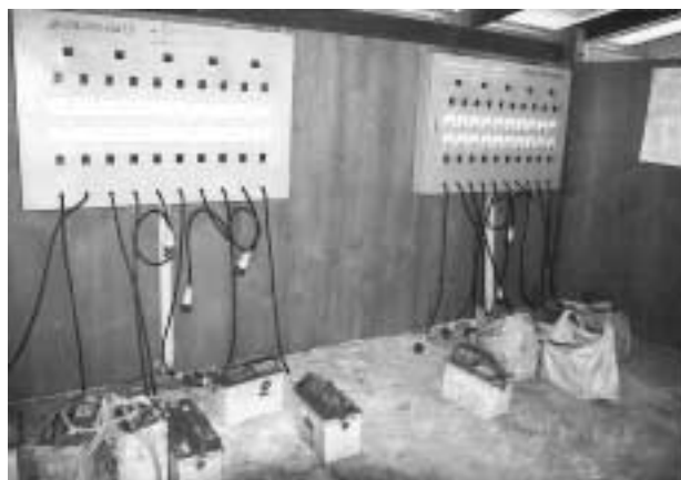
ソーラーパネルからの電気を充電中の自動車用バッテリー
