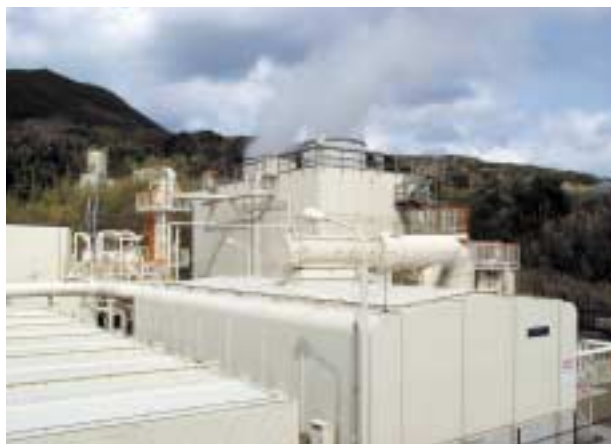
冷却等から蒸気を出す東京電力地熱発電所。手前の建屋にタービン発電機が収まる
