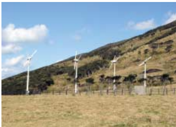
八丈町ふれあい牧場に設置された風力発電。4基で最大20kWの出力があり牧場で消費する。余った電力はバッテリーに蓄え、不足する場合はディーゼル発電機を運転する
