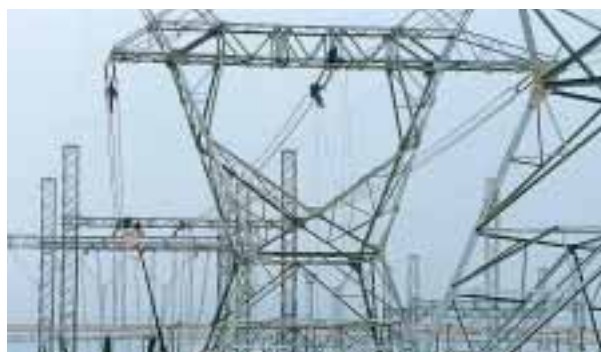
アンタイドローンによって敷設された送電線設備
