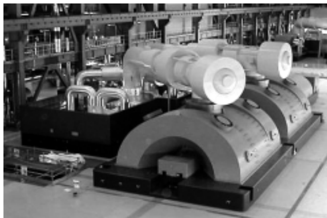
電源開発(株)橘湾発電所2号機 1 050 MW 蒸気タービン 世界最高レベルの蒸気条件（25.1 MPa , 600 /610 ）， 性能の国内火力最大容量機
