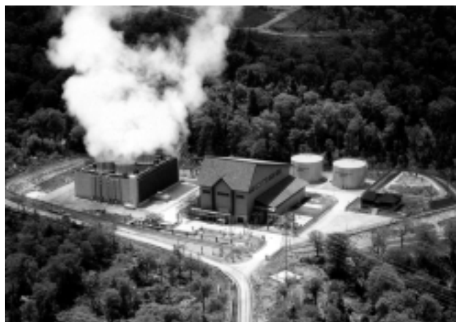
東北電力(株)澄川発電所 50 MW 地熱発電プラント 環境に調和して安定した出力が得られる自然エネルギー利用発電プラント
