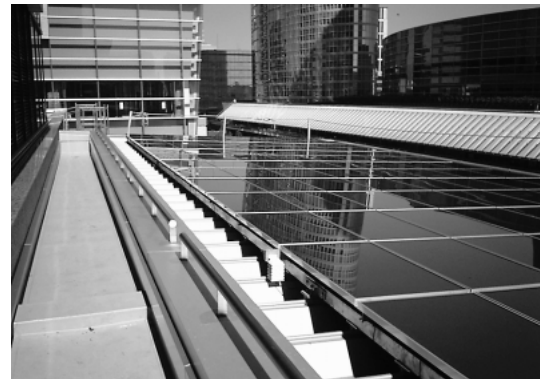
図16 高効率アモルファスシリコン太陽電池 アモルファスシリコン太陽電池の設置例を示す。家庭でも環境保全に寄与できる。
