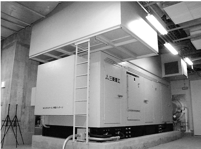
図 1 発電装置本体外観
