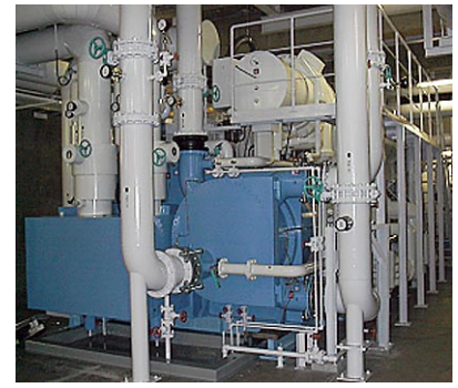
図10 過流量対応ターボ凍機設置状況
