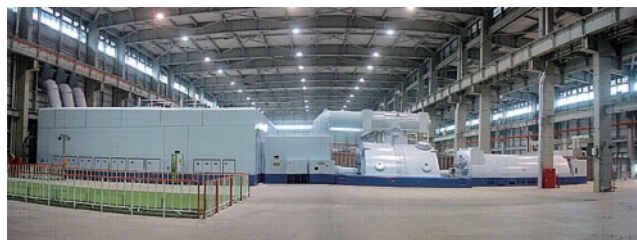
図5 川崎火力発電所1号系列第3軸
