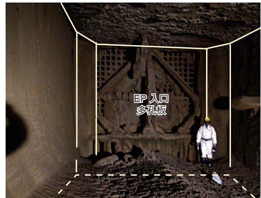
図15 EP入口煙道灰堆積状況
