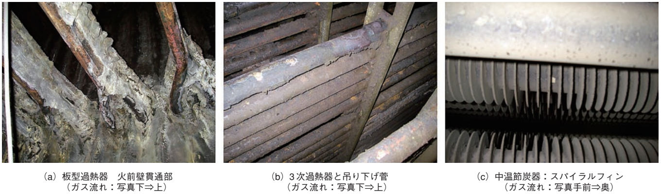
図8 炉内・煙道機器灰付着状況
