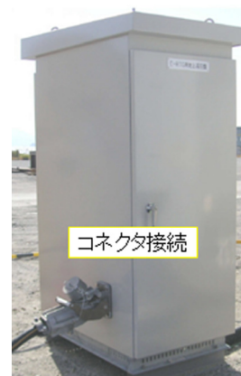
図7 地上給電設備
