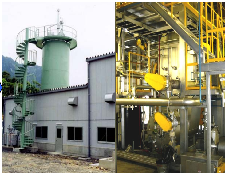
メタン発酵槽
