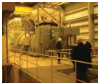
セヴェルナヤ・ガス火力複合発電所
