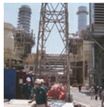
フーミー第2火力発電所
