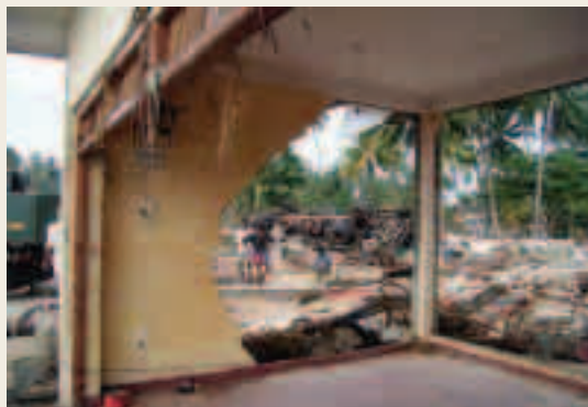
津波により被災した家屋
