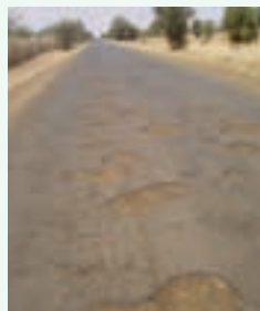
事業対象区間の劣悪な路面状況
