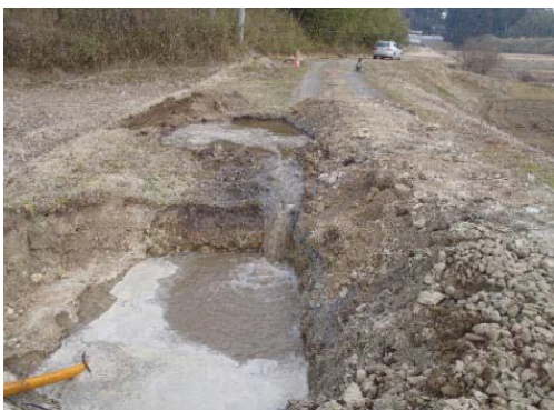
【桜岡幹線用水路の漏水箇所】
