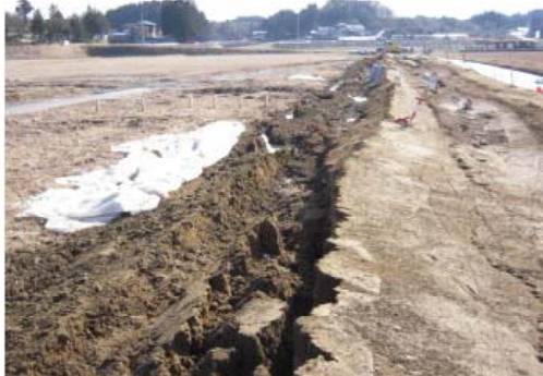
【飯島地区幹線農道亀裂箇所】
