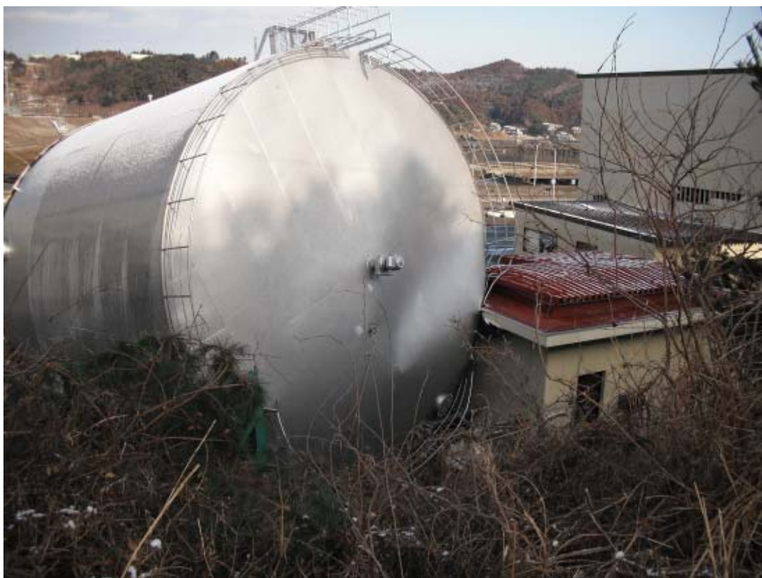
重油貯蔵タンク倒壊写真
