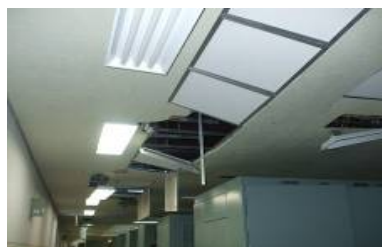
天井化粧板の脱落
