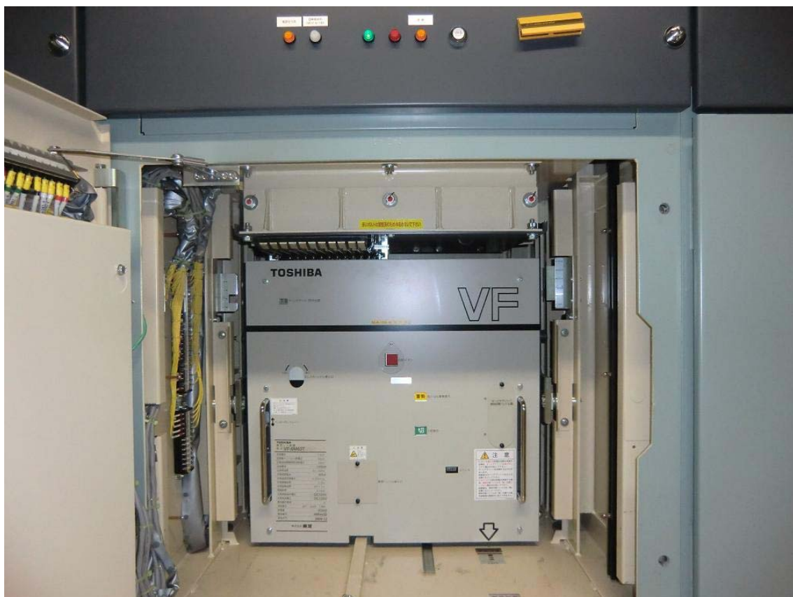
真空しゃ断器（VCB） 接続位置
