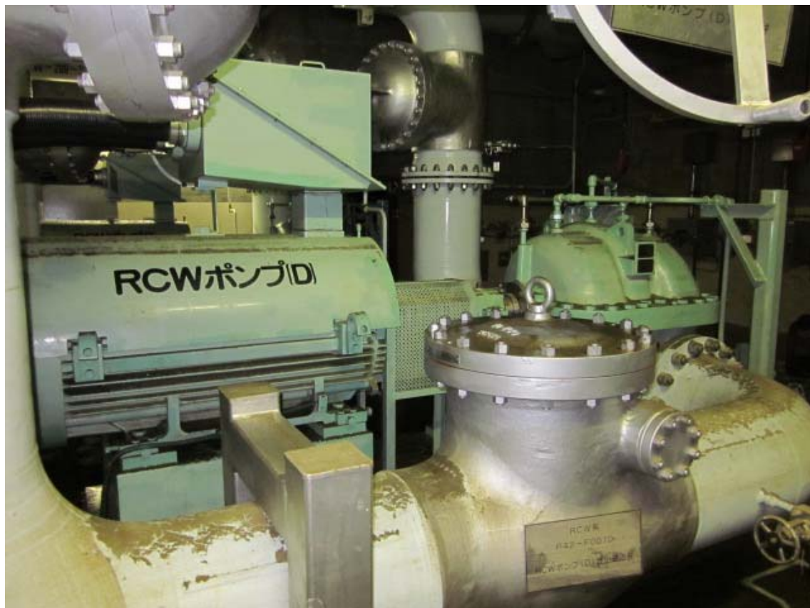
RCWポンプ（D）（海水抜き取り後）
