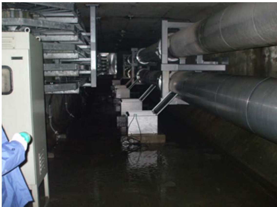
循環水ポンプ自動停止用水位計
