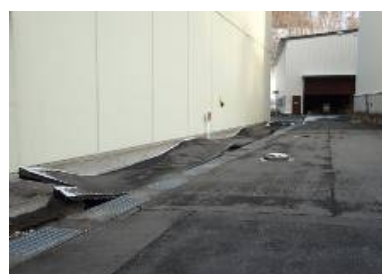
舗装道路陥没
