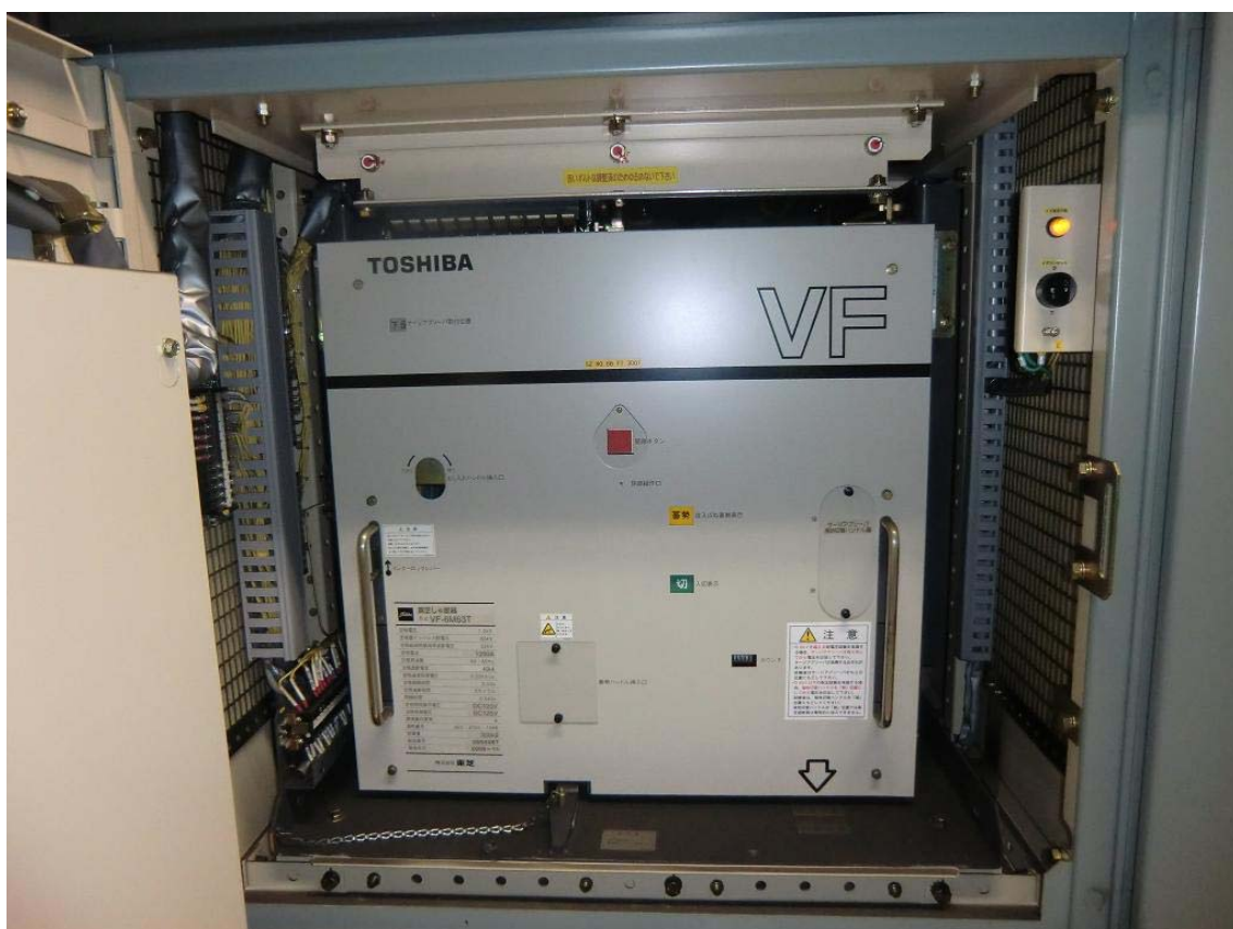
真空しゃ断器（VCB） 断路位置
