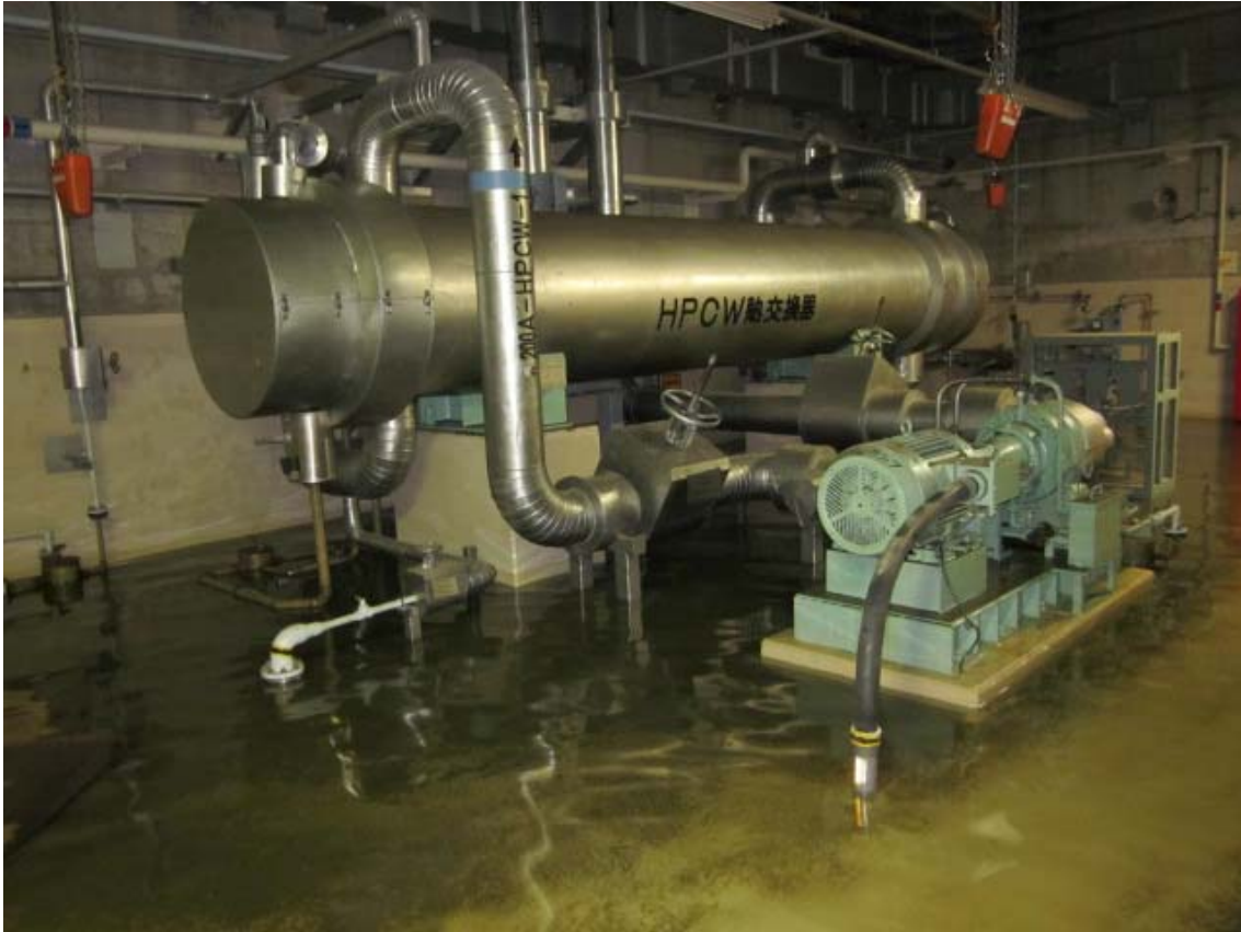
H P C W熱交換器室における海水の浸水状況
