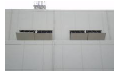
タービン建屋ブローアウトパネル外れ
