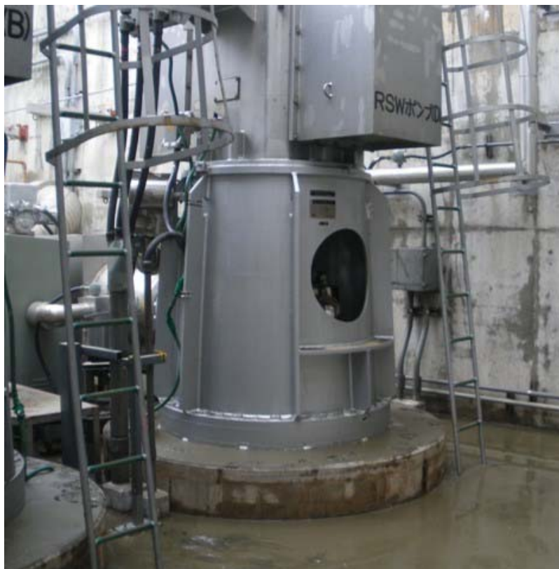
R S Wポンプ（D）（海水排水後）
