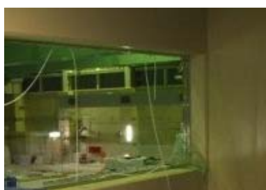
燃料交換機制御室の窓ガラス割れ
