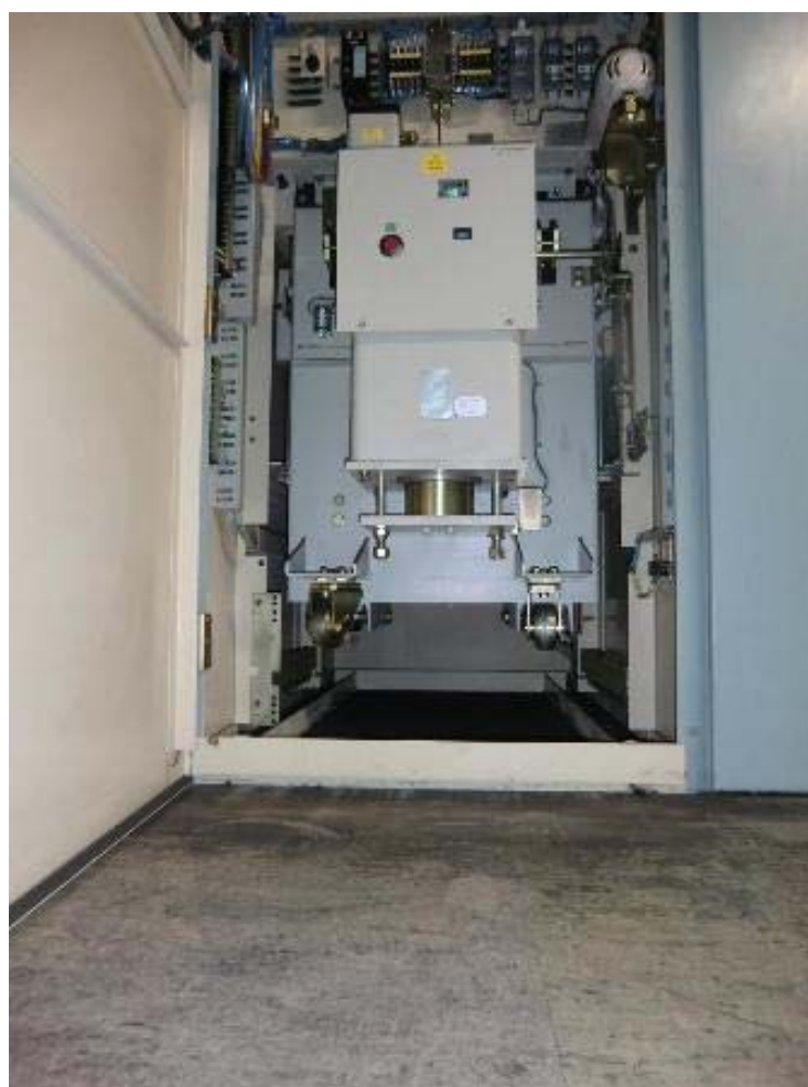
健全な高圧電源盤 現場写真
