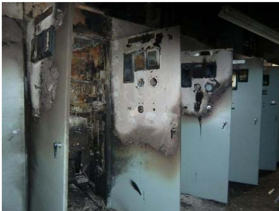
高圧電源盤 現場写真
