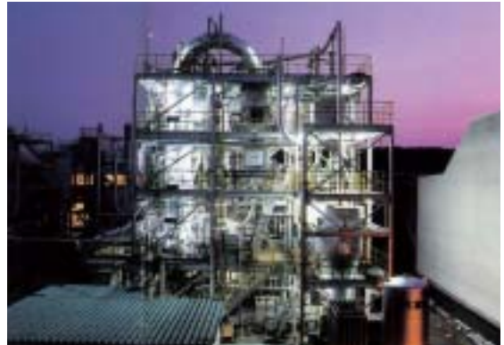
石炭ガス化試験装置
