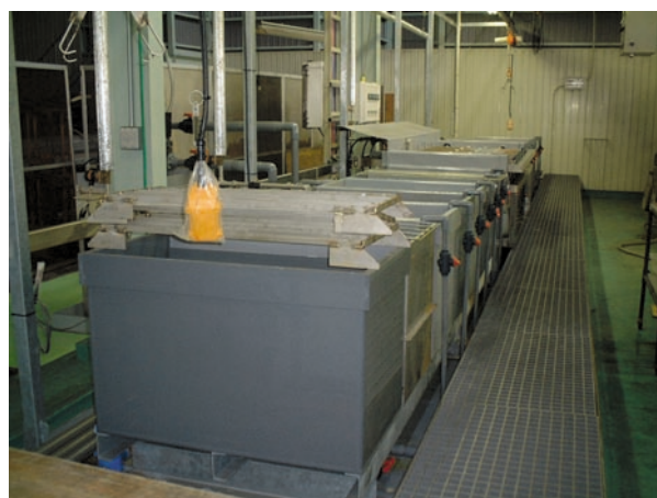
図2 高知精工メッキ(株)の新設ライン
