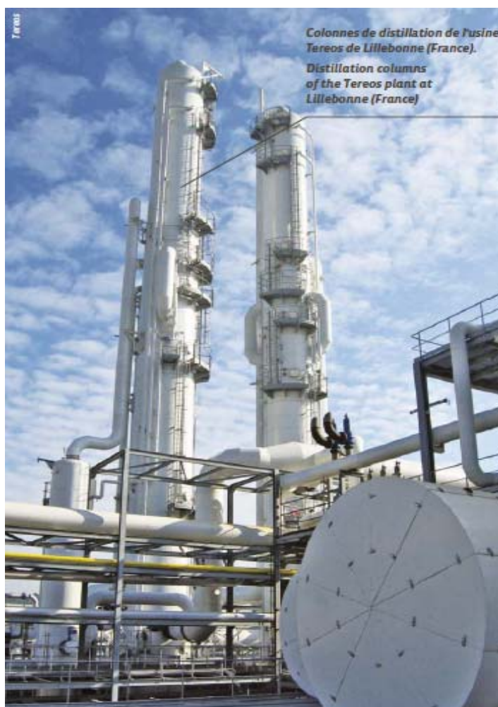
フランス Lillebonne にある Tereos 社の工場の蒸留塔
