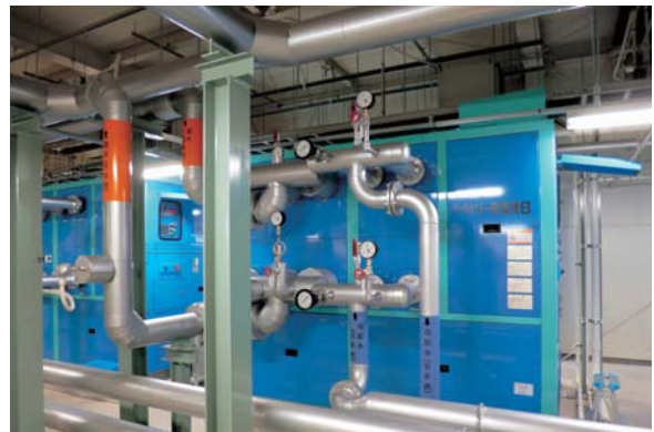
発電機：3機設置されている。
