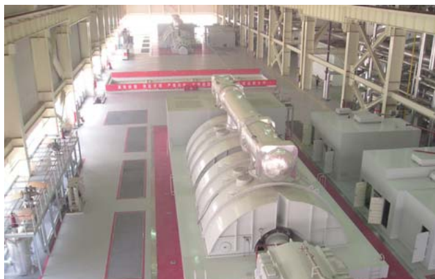
山西魯晋王曲発電有限責任公司納め王曲第一期発電所の外観(上)と蒸気タービン設備(下)
