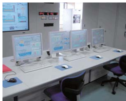
3 水戸市水道部楮川浄水場の中央監視装置
