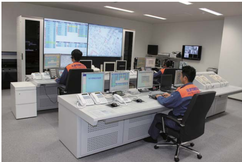
9 佐渡市消防本部高機能消防指令センターの指令室
