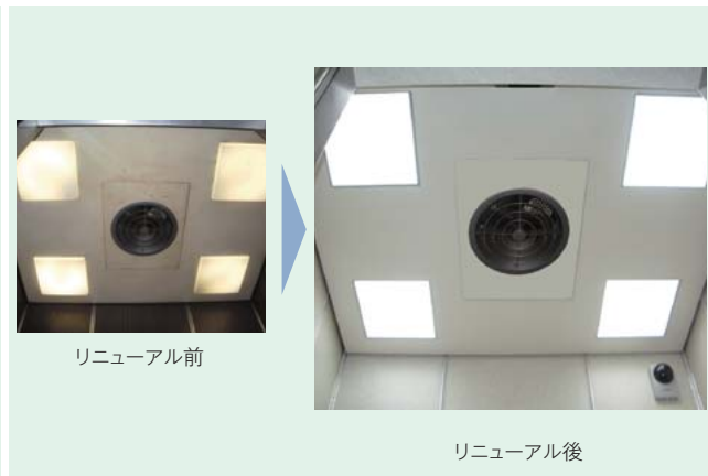
7 エレベーター用天井照明のリニューアル前後の比較
