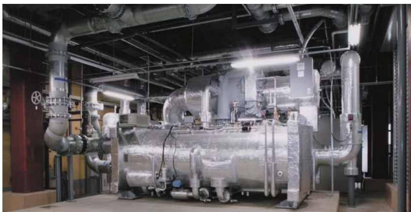
14 日本メクトロン株式会社奥原工場 高効率ターボ冷凍機の外観
