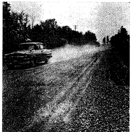
写真-10 施工後約10ヵ月経過 もはや防塵効果はなくなり、無処 理区間とほとんど同じである。
