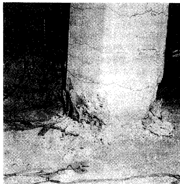
写真-2 B-RC 破壊状況
