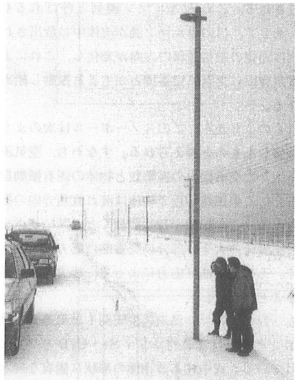
写真-1 腕木の折れたスノーポール
