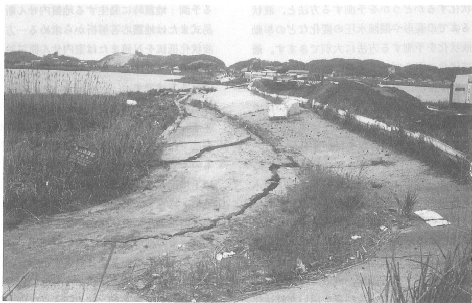
写真-1 八郎潟干拓堤防の被害（日本海中部地震）
