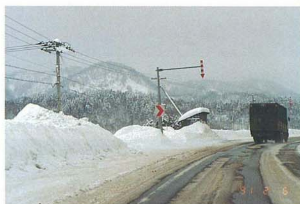
写真-22 スノーボール（固定式視線誘導柱） アームフランジ型支柱の傾斜が見られる設置例
