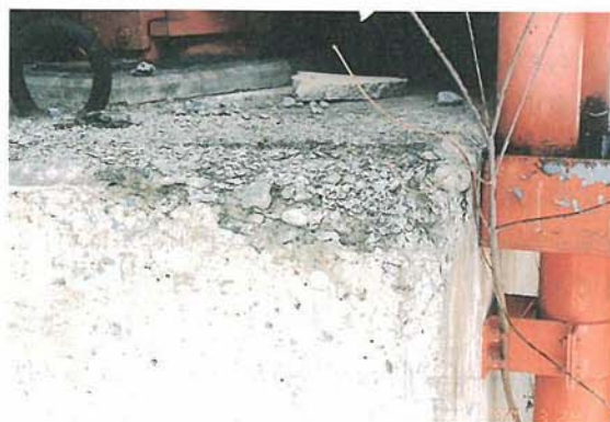
写真-3 橋台の凍害
