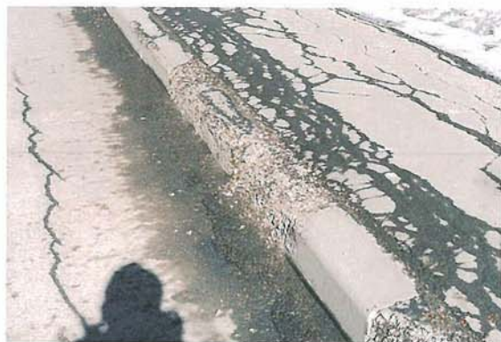
写真-1 縁石の凍害
