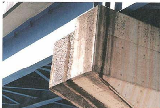
写真-2 橋脚の凍害
