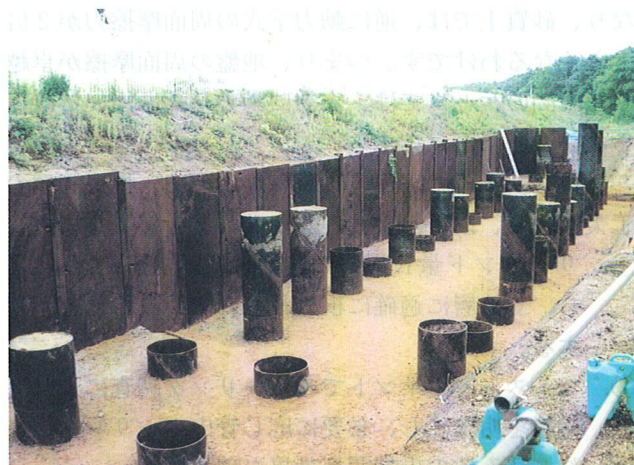
写真-1 杭高止まり状況
