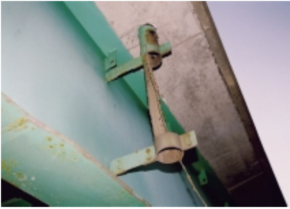
写真 - 12 排水管の腐食 (L 橋)
