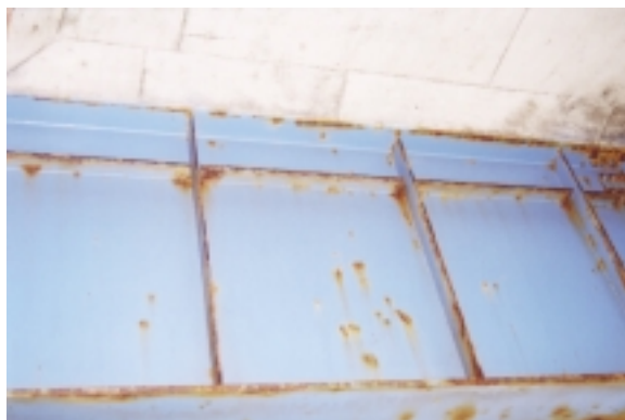
写真 - 9 補剛材の劣化状況
