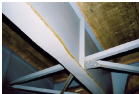
写真 - 11 下フランジでの腐食
