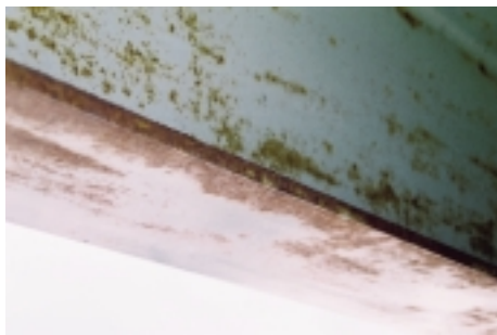
写真 - 2 I橋の劣化状況（下フランジ）
