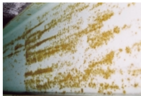
写真 - 1 I 橋の劣化状況 (Web)
