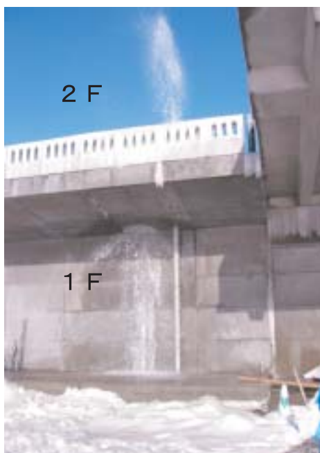
写真-2 現地での噴き出し状況
