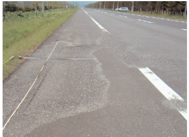
写真 - 3 セミホット混合物工区の舗装のはがれ
