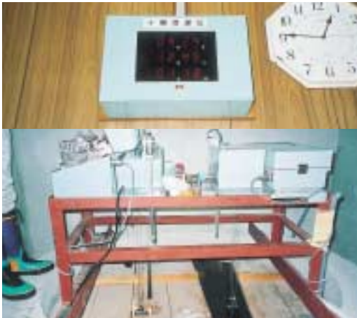
写真4 検潮所の井戸。下から海水を取り入れ、そこに浮きを浮かべてその高さを測る。上は潮位を示すインジケータ。
