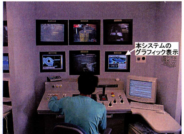
Photo 2 オペレータパネルに設置したグラフィック表示 (The Graphic Display on Operator Panels)
