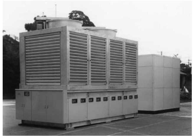
図10 氷蓄熱式チルドタワー外観写真
