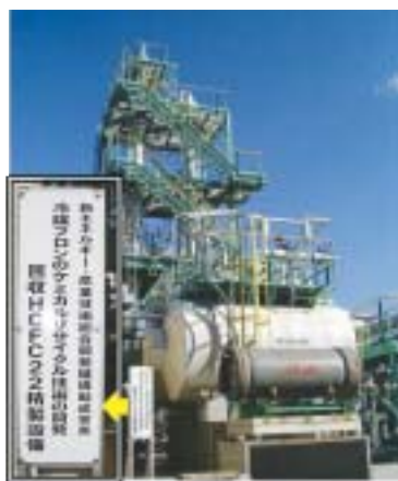
図3 冷媒精製設備
